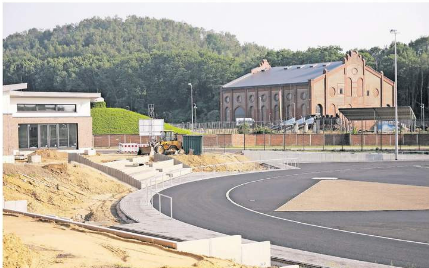
Der im Bau befindliche Sportplatz am Energicon in Alsdorf nimmt Formen an. Hier ist nach Angaben der Stadt ohnehin die Verfüllung des Kunstrasenplatzes mit Kork vorgesehen.
