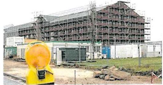
Die Warnlampe steht auf Gelb: Erneut wird das Herrichten der Kraftzentrale für das Kultur- und Bildungszentrum teurer. Foto: Karl Stüber
