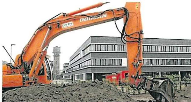
Fünf Wochen vor der Fertigstellung schwer beschädigt: Das Kultur- und Bildungszentrum in Alsdorf bleibt nach einem schweren Wasserschaden noch für Monate eine Baustelle. Foto: Karl Stüber
