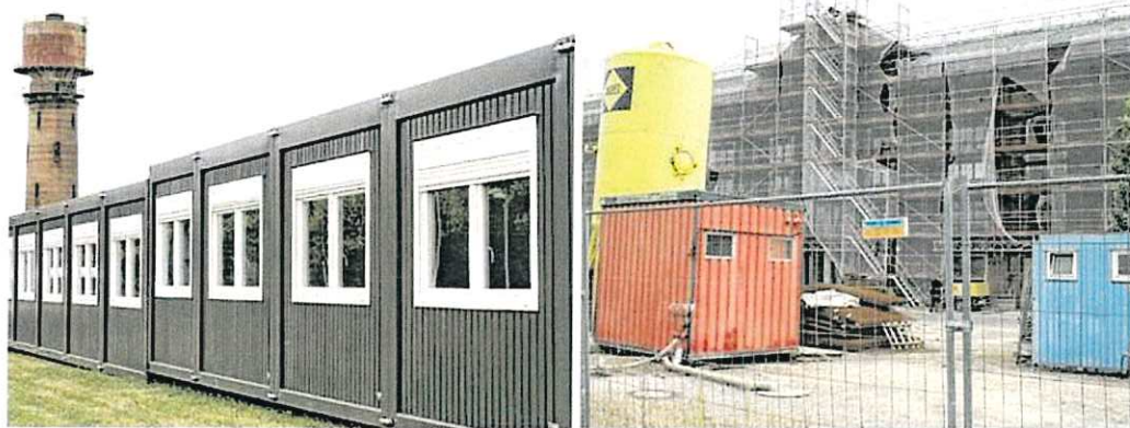
Trauriger „Rückbau“ im Kultur- und Bildungszentrum Alsdorf: Der mit Wasser vollgesogene Boden der Turnhallen im Untergeschoss musste komplett herausgerissen werden – der Trockenlüfter läuft (Bild oben). Die zusätzlich am Kubiz aufgestellten Container werden noch länger auf die Nutzung durch Schüler warten müssen (links unten). Auch das Herrichten der alten Kraftzentrale hat sich verzögert (rechts unten). Fotos (2): Karl Stuber
