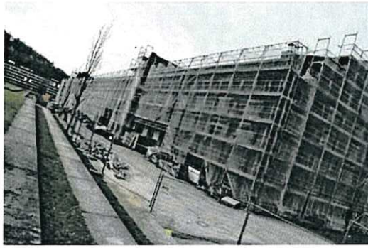
Sorgenkind Kubiz: Die Stadt Alsdorf stellt sich auf eine erneute Kostenexplosion ein. Das Langhaus ist wohl das Hauptproblem. Foto: vm
