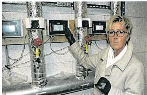
Aus dem verheerenden Wasserschaden die Konsequenz gezogen: GSG-Geschäftsführerin Kathrin Koppe erläutert im Untergeschoss des Neubaus des Kultur- und Bildungszentrums Alsdorf die vier eingebauten Leckageschutzeinrichtungen. Foto: Karl Stüber
