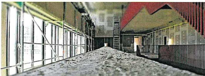
Blick ins Treppenhaus: Die Geländer sind schon montiert, die Betonoberfläche wie hier im Bildvordergrund wird unter Holz verschwinden.
