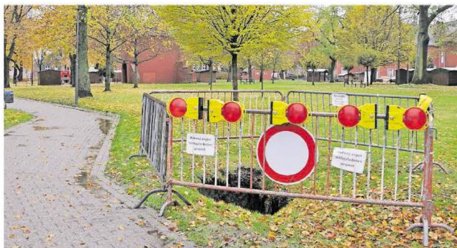
Erdreich abgesackt: Der Boden im Alsdorfer Burgpark hat auf einer Fläche mit einem Durchmesser von rund einem Meter nachgegeben. FOTO: THOMAS VOGEL
