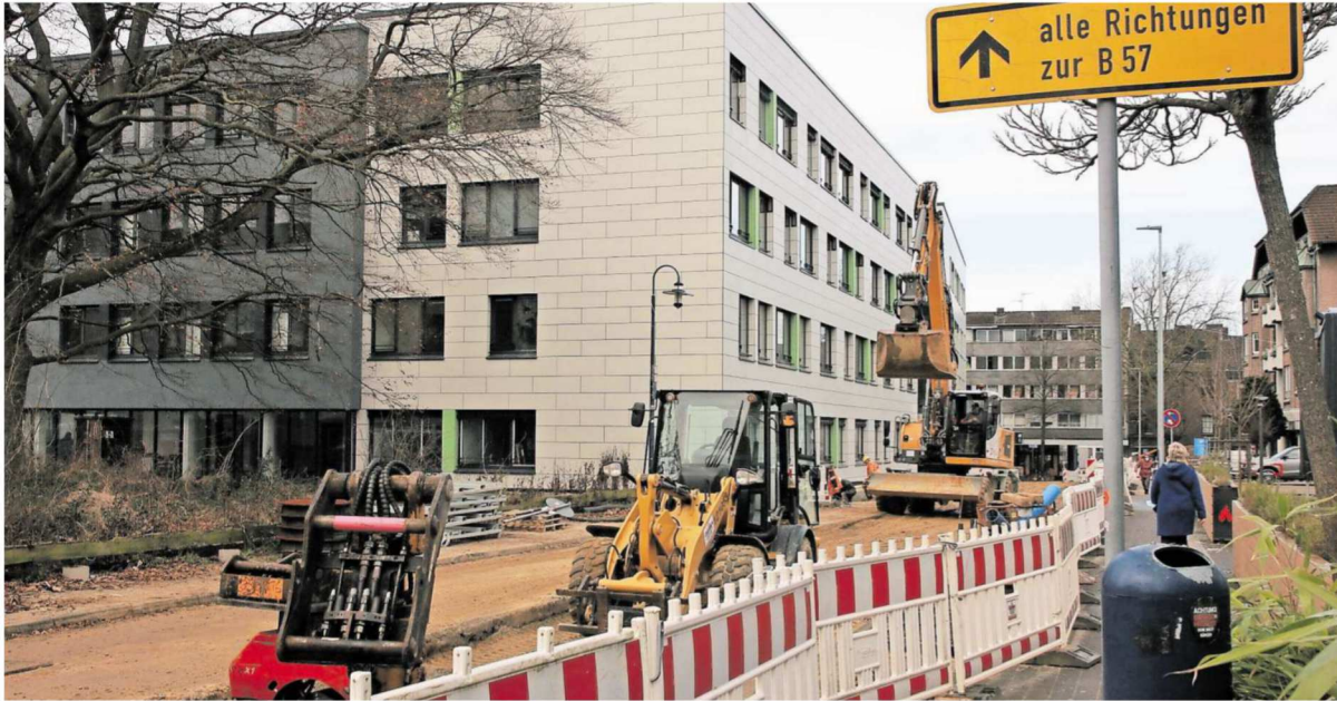
Das Bürogebäude für das Jobcenter an der Hubertusstraße in Alsdorf ist fast fertig. Im Außenbereich wurde ein Staukanal „unter die Erde gebracht“. Hier laufen noch Restarbeiten.
