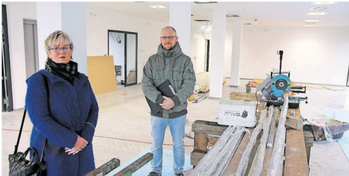
Im Eingangsbereich fehlt noch das Mobiliar, für das aber die Geschäftsführerin der Stadtentwicklung Alsdorf GmbH, Kathrin Koppe, und Architekt Thomas Koriath noch rechtzeitig sorgen werden.
